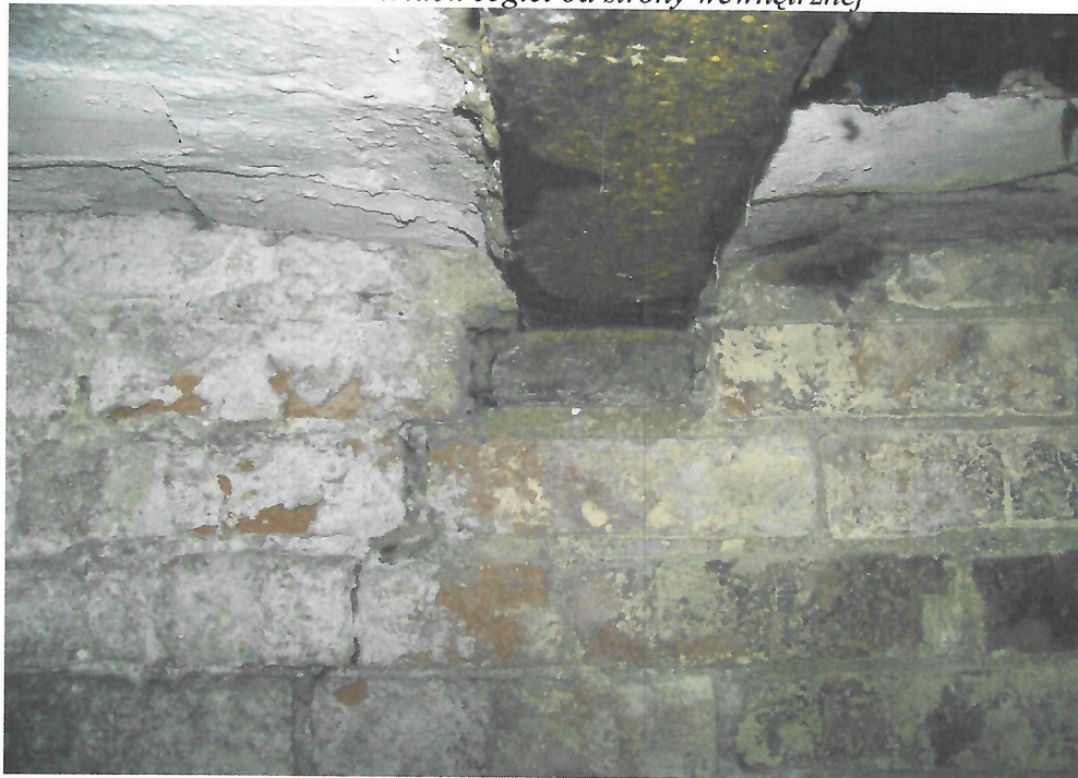
Fot. nr 12 Oparcie belek stalowych stropu na murze -stare pęknięcie
