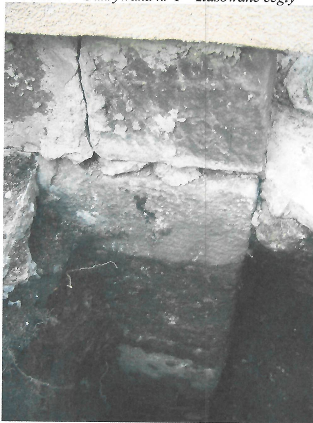
Fot. nr 8 Odkrywaka nr 1 – Obluzowane kamienie
