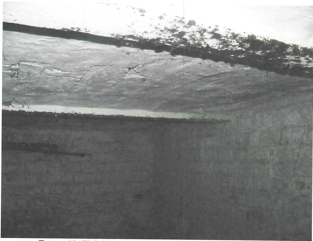
Fot. nr 13 Widok ścian piwnicy i zarysowanego stropu kleina
