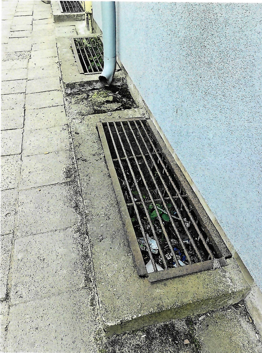
Zdj.1 – aktualny wygląd studzienek piwnicznych w budynku przy ul. Traugutta 14 – wyniesione ok. 5cm ponad chodnik
