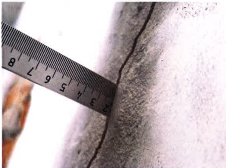
Zdj. 3. Pomiar szerokości rozwarcia rysy
