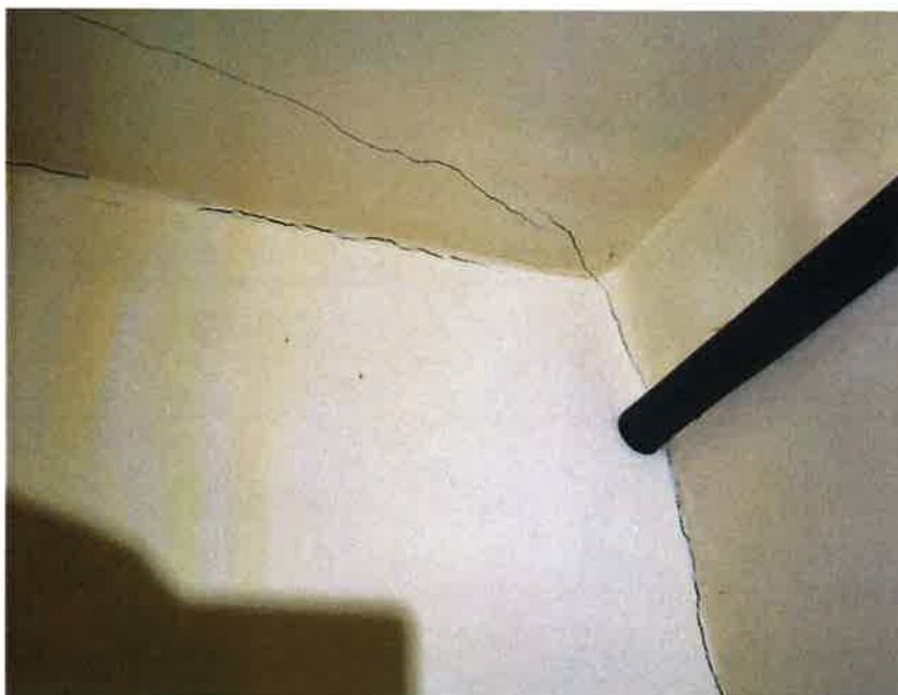
Zdj. 10 ÷ 12. Przykładowe pęknięcia w pozostałych lokalach
